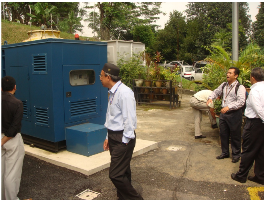
Lawatan di lokasi Genset
