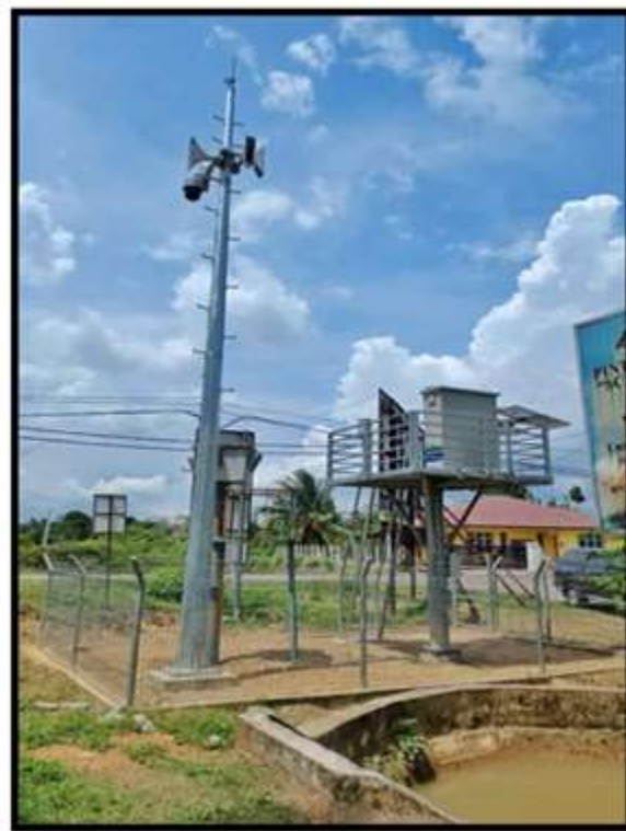
Gambar 4: Stesen Hujan, Aras Air, Kadar Alir, Siren dan Kamera Web di Sg. Batang Melaka di Gadek
