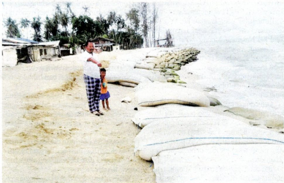
Seorang penduduk Kampung Pantai Kundor menunjukkan keadaan geo bag yang susun untuk menahan hakisan pantai, semalam.
