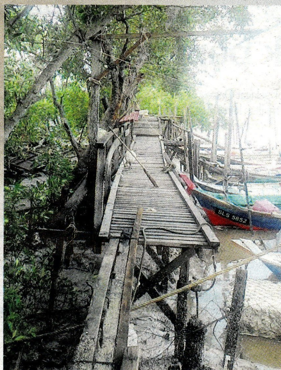
Jeti kayu rosak didakwa disebabkan fenomena air pasang di Parit 3.
