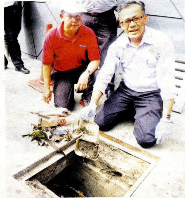
Mohd Zain (kanan) mengeluarkan sisa pepejal yang tersangkut pada sambungan kabel yang menggunakan saluran longkang di kawasan Bukit Bintang.
