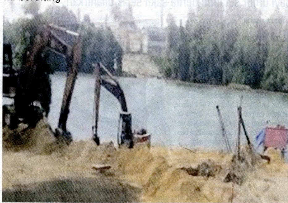
Keadaan tebing sungai di mana lokasi aktiviti menyedut pasir dijalankan sejak dua bulan lalu.
