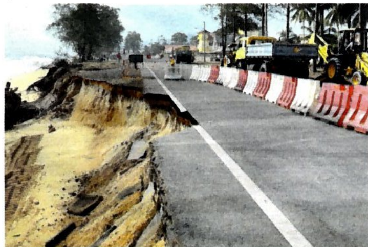
KERJA-KERJA menambak semula tebing pantai yang runtuh serta terhakis akibat dibadai ombak besar dijalankan di Jalan Pantai Teluk Lipat, Dungun baru-baru ini.
