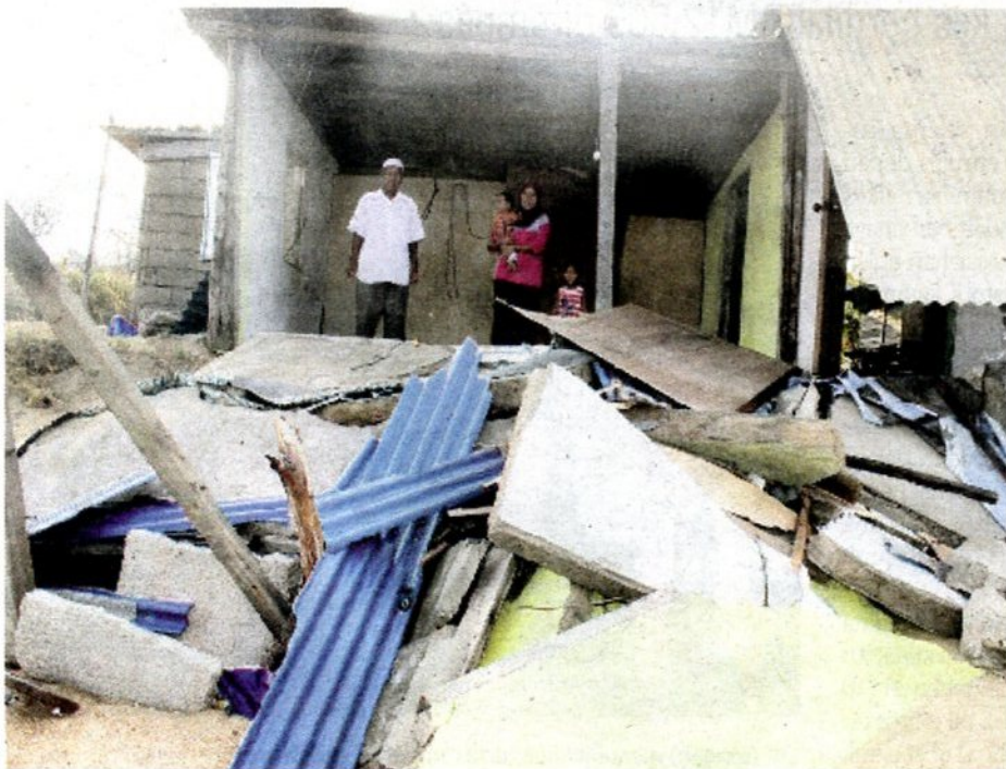
Hazura dan Mohamad hanya mampu melihat keadaan rumah yang roboh dibadai ombak.
