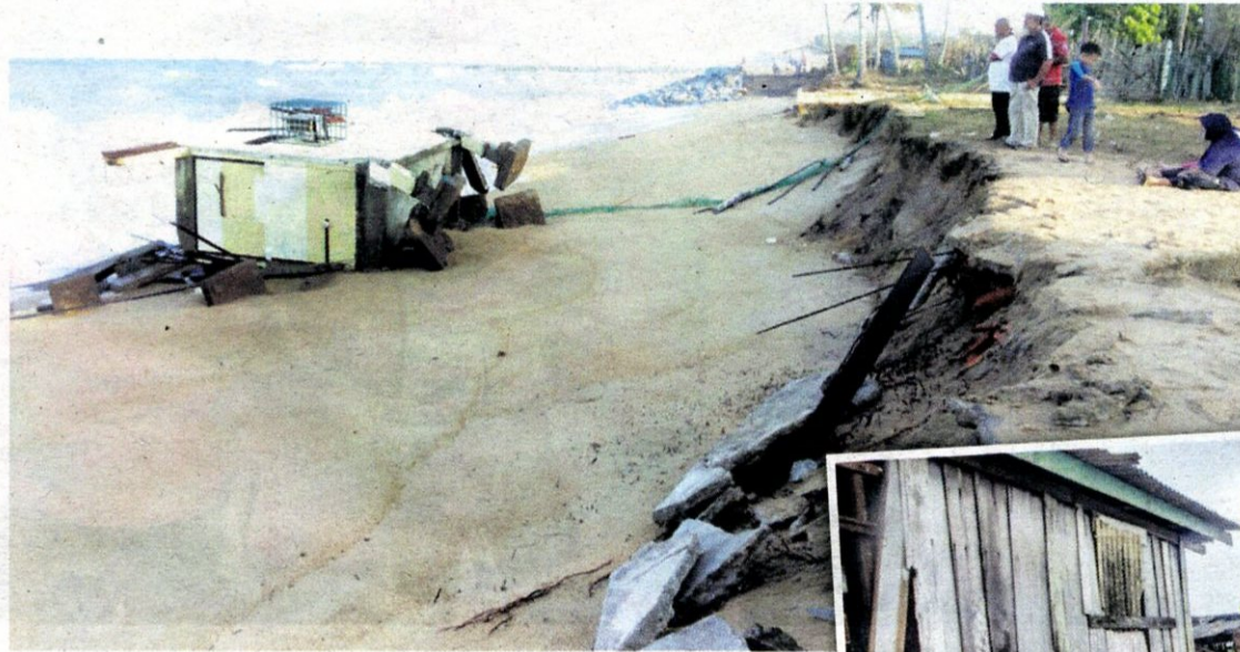
Kedadaan hakisan di Kampung Tengah.
