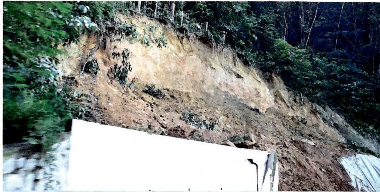
KAWASAN tanah runtuh yang meresahkan penduduk setiap kali hujan lebat akan menimbus jalan raya dari Berapit ke Butterworth berhampiran Kampung Sungai Lembu, Permatang Pauh, Pulau Pinang.
