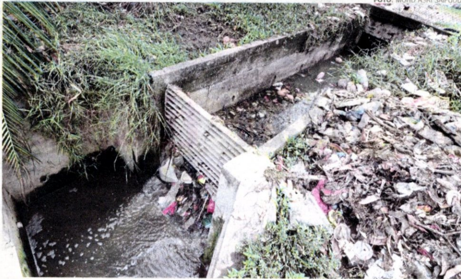
KEADAAN perangkap sampah yang tidak diselenggara dan dipenuhi sampah-sarap.
