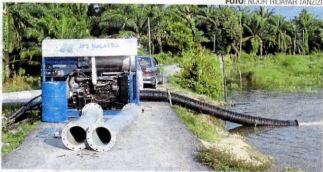
PAM air dipasang di Kampung Padang Serai, Pantai Remis.
