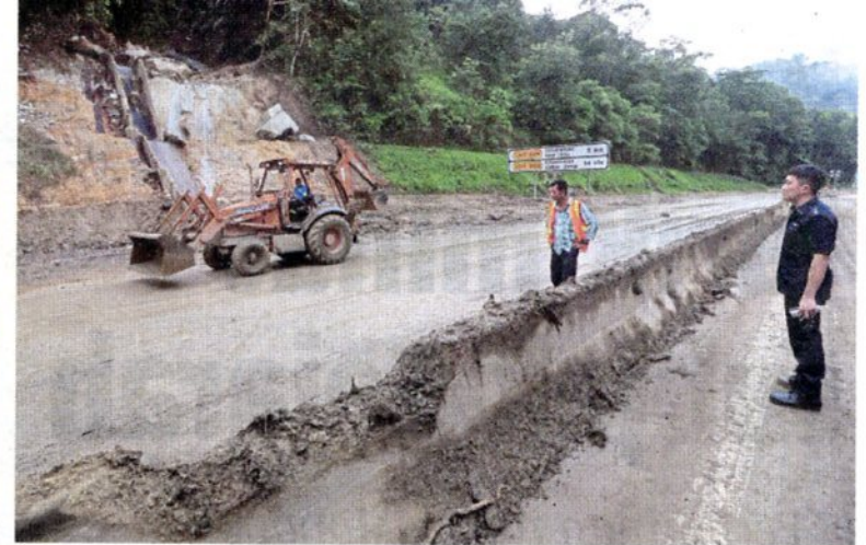
Kerja pembersihan jalan masih dijalankan di sekitar kawasan tanah runtuh. [FOTO GHAZALI KORI/BH]
