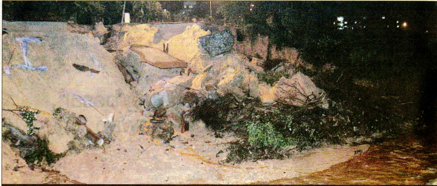
TEBING Sungai Long yang dikhuatiri runtuh sehingga merosakkan jalan raya di Jalan Sungai Long 1/7, Kajang.
