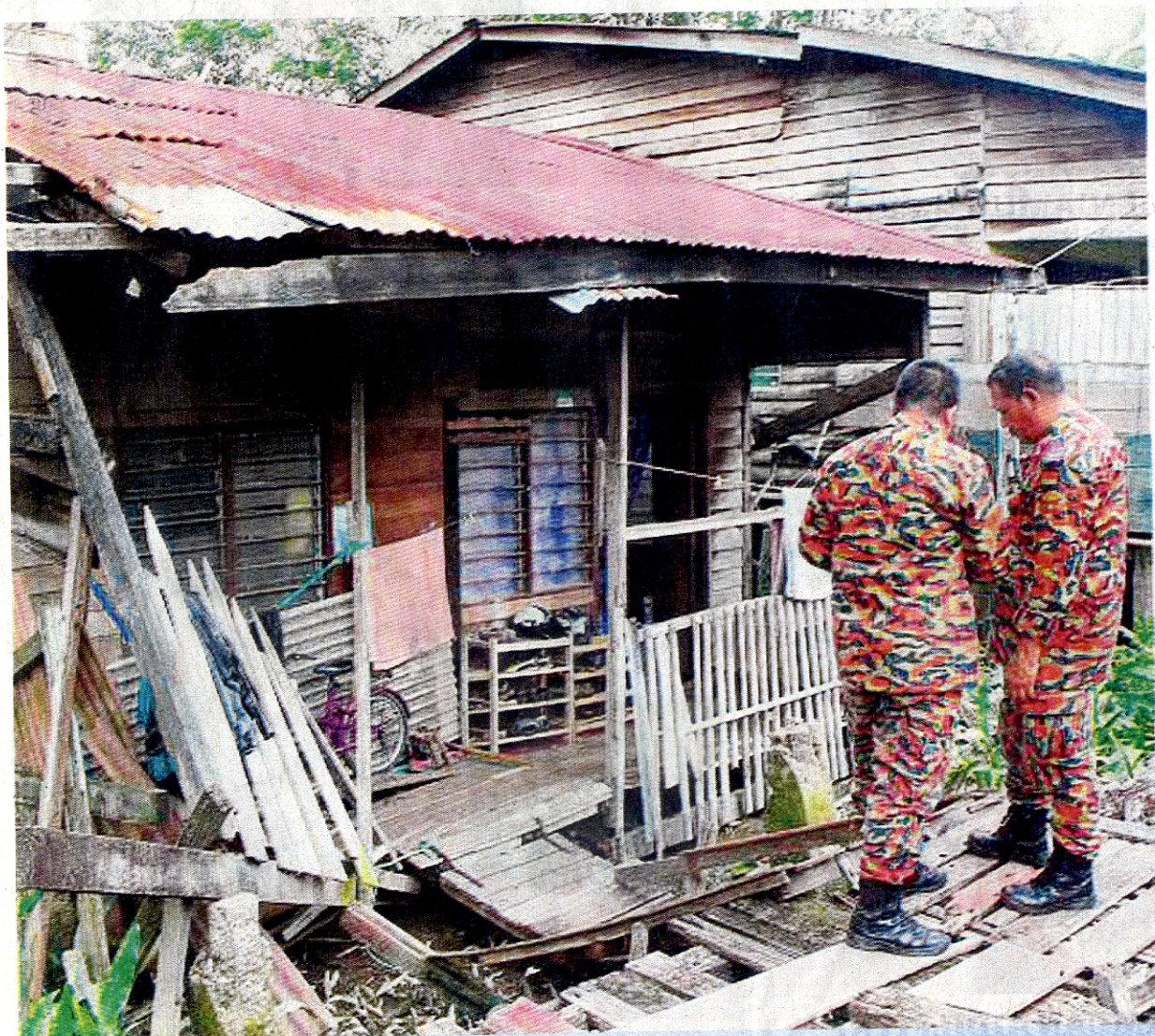
DUA anggota bomba dan penyelamat menjalankan siasatan setelah sebuah rumah runtuh di Kampung Tebu, Pekan Lama, Sungai Petani, Kedah, semalam.
