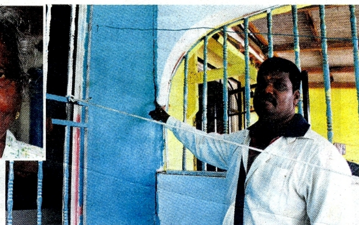
Ravi menunjukkan jarinya yang boleh masuk ke celah dinding selepas retak akibat hakisan tanah di hadapan rumah setelah cerun Sungai Guntung runtuh sejak 10 tahun lalu.
