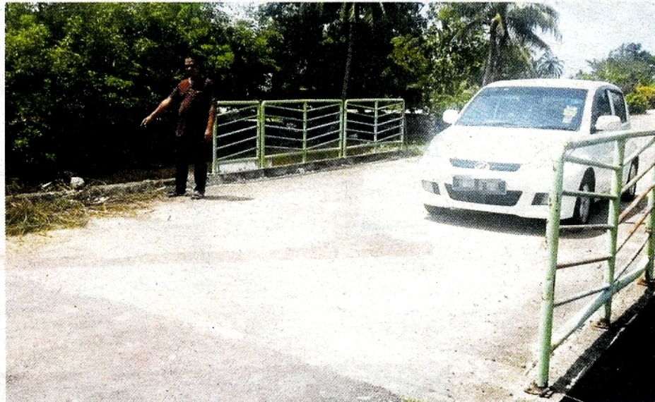
Mat Azhari menunjukkan sebahagian penghadang kiri jambatan yang runtuh dan masih belum dibaik pulih pihak berwajib.
