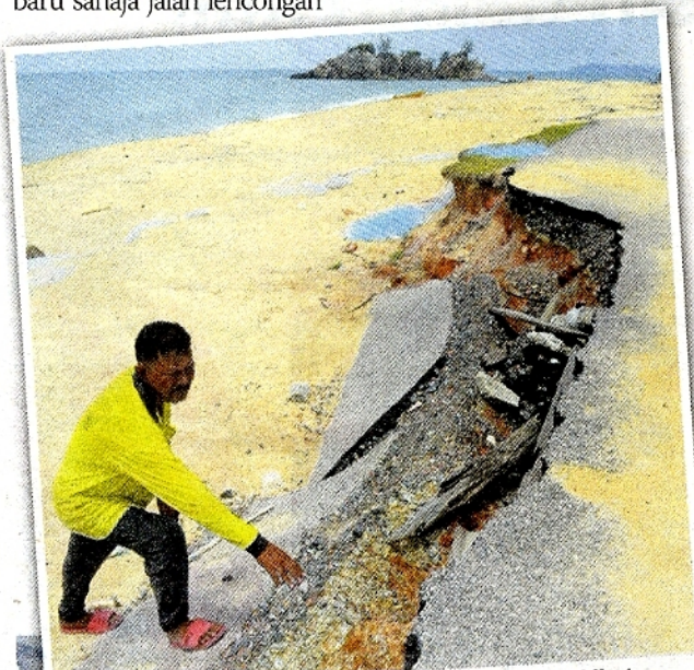
Abdul Ghani menunjukkan kesan runtuhan jalan akibat hakisan pantai di Kampung Tanjung.
