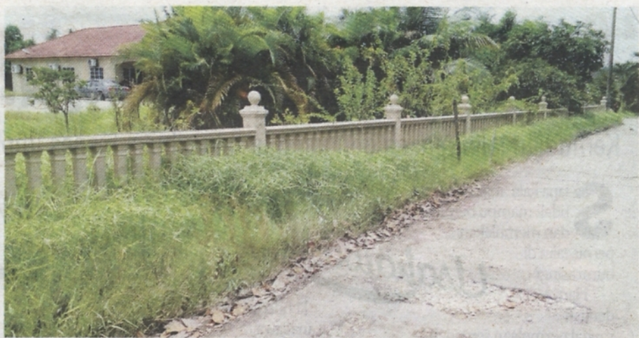
Saluran air yang ditambah penduduk sehingga menyebabkan saluran mengecil.
