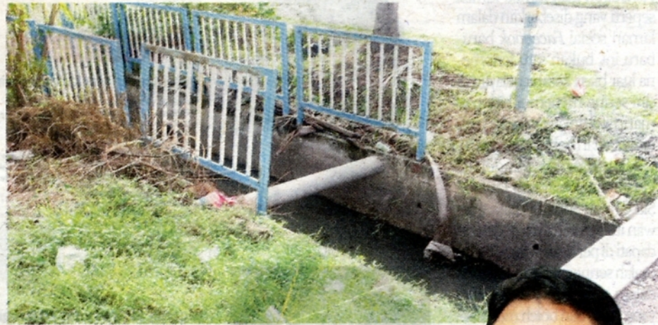
Besi pengadang yang rosak memberi risiko kemalangan kepada pengguna jalan raya.
