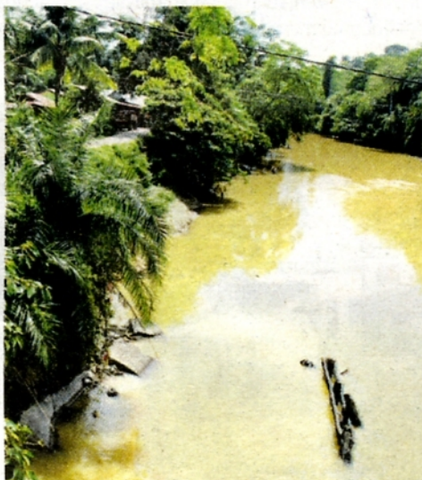
Hakisan sungai turut menjejaskan kedudukan jambatan.
