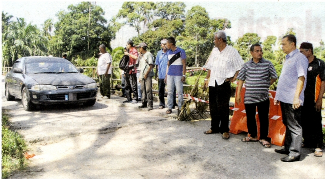
Jambatan di Kampung Rantau Panjang yang retak mencemaskan penduduk setempat.
