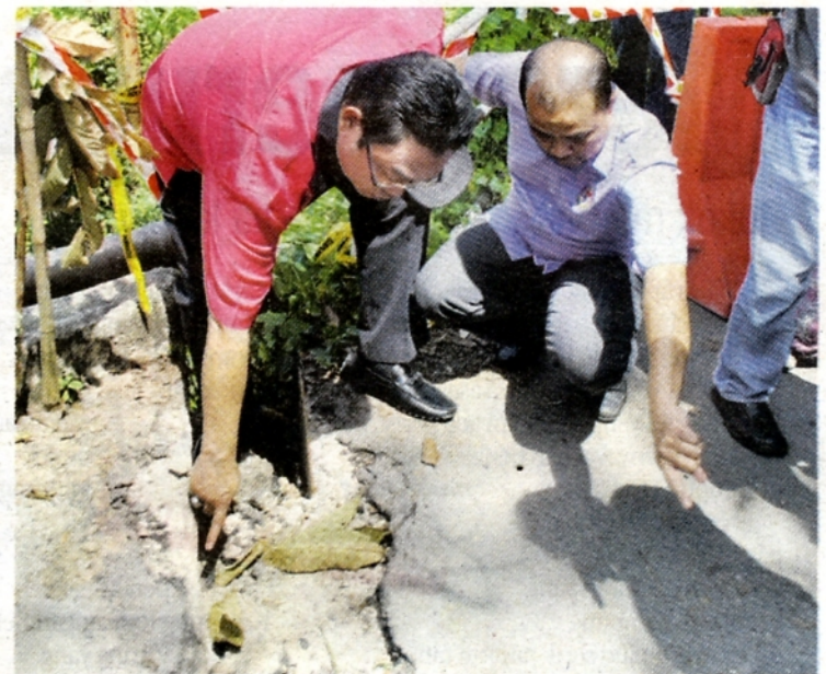
Noh (kiri) dan Sulaiman menunjukkan kesan keretakan jambatan.
