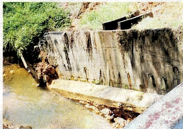
JPS akan mengambil tindakan segera bagi menyelesaikan isu hakisan.
