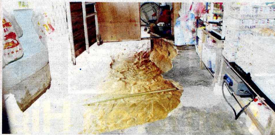
LANTAI sebuah rumah berlubang akibat banjir kilat dan tanah runtuh di Lembah Bertam, Cameron Highlands
