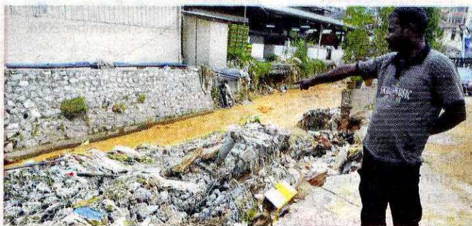
SEORANG penduduk, L. Maniam menunjukkan sebahagian tembok konkrit yang roboh akibat banjir kilat yang melanda Kampung Baru Ringlet, Cameron Highlands.
