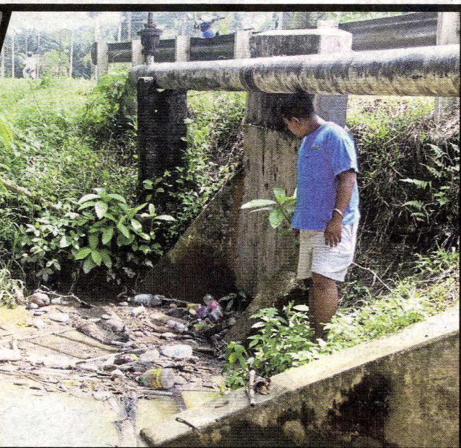
SISTEM perparitan tidak teratur dan tersumbat mengakibatkan Kampung Raja dinaiki air.
