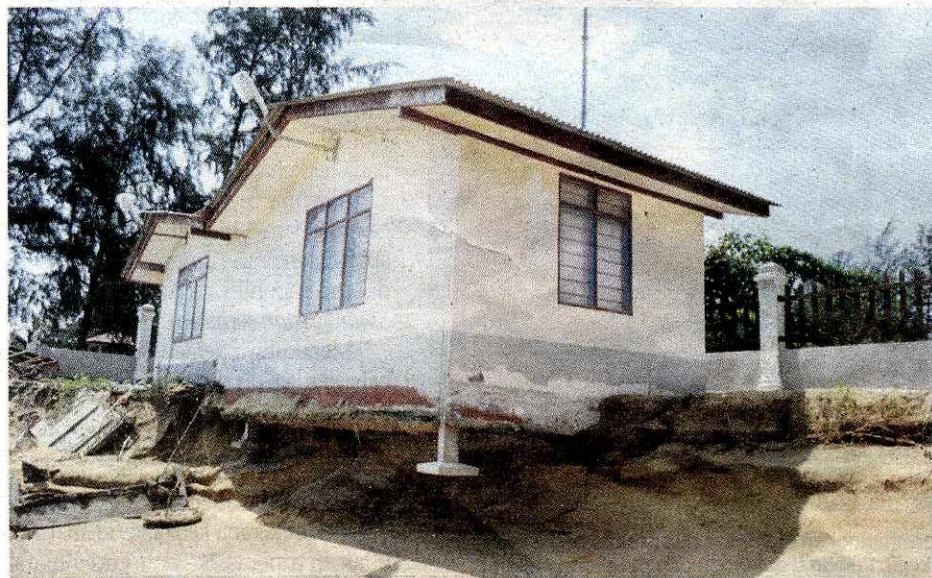
Salah satu bangunan di Stesen Penyelidikan Tenaga UMT yang tergantung akibat hakisan pantai.
