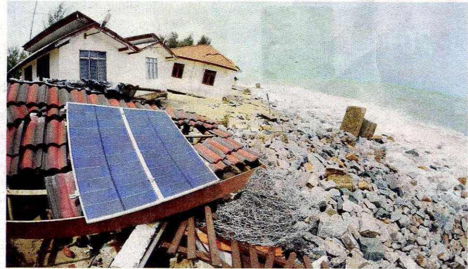
STESEN kajian sumber tenaga diperbaharui UMT rosak dan runtuh akibat hakisan ombak di Pantai Tok Jembal, Kuala Terengganu baru-baru ini.
