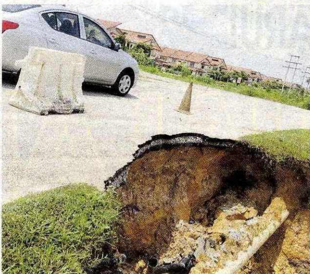
Kon dipasang berdekatan tebing runtuh sebagai langkah keselamatan sementara menunggu kerja pembaikan dibuat.
