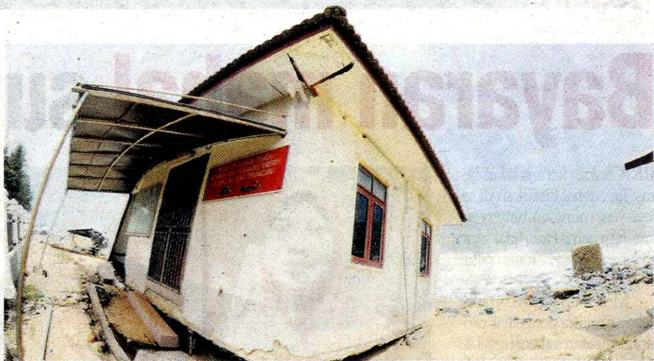
Stesen Kajian Sumber Tenaga Keterbaharuan UMT di pantai Tok Jembal yang runtuh dua hari lalu akibat hakisan dan dipukul ombak menunggu masa untuk hanyut ke laut. Foto Bernama.
