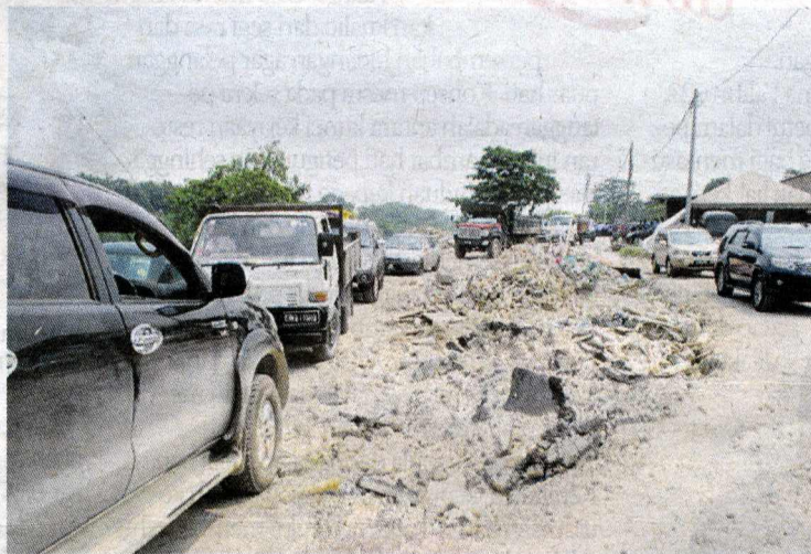
Jalan yang mendap dan rosak teruk di Kampung Jaya Sepakat.
