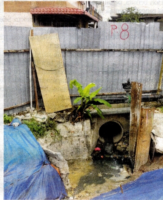
Tiada pengendalian sempurna di tapak pembinaan MRT sebelum ini didakwa menjadi punca banjir berlaku di Jalan 3, Kampung Baru Batu 11.
