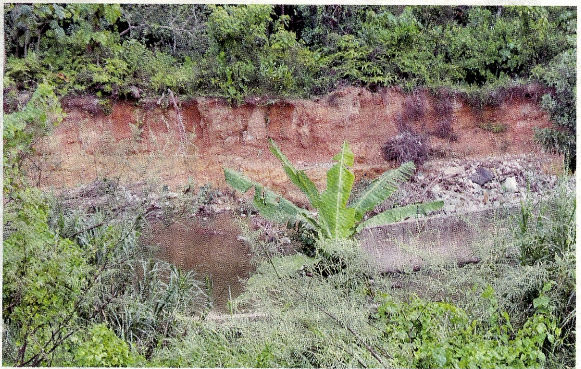
Tembok longkang monsun di Taman Dahlia yang runtuh mengakibatkan hakisan.
