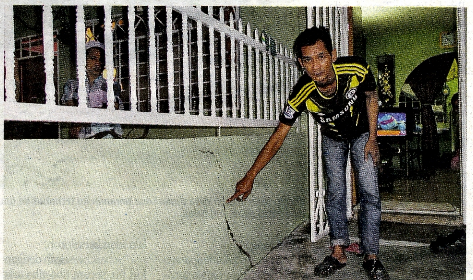
Mohd Sabari menunjukkan keretakan pada dinding luar rumahnya dipercayai akibat hakisan longkang monsun di Jalan Dahlia 5.
