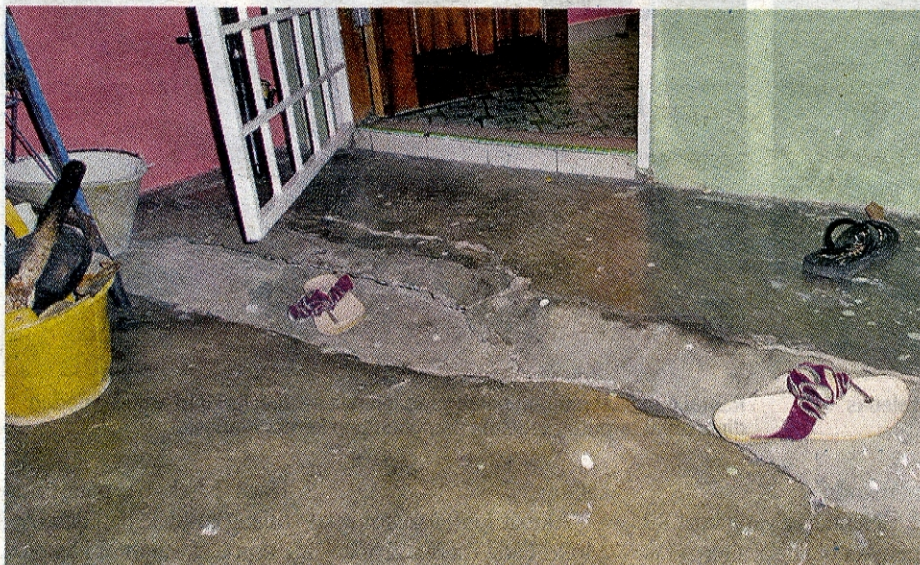
Lantai salah sebuah rumah penduduk di Jalan Dahlia 5 yang merekah dipercayai akibat hakisan longkang monsun.
