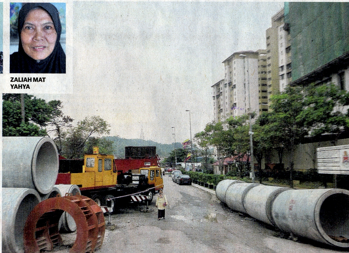
PENDUDUK mendakwa kontraktor projek berhampiran PPR Seri Anggerik, Jalan Klang, Kuala Lumpur mengabaikan aspek keselamatan sehingga mengundang bahaya.
