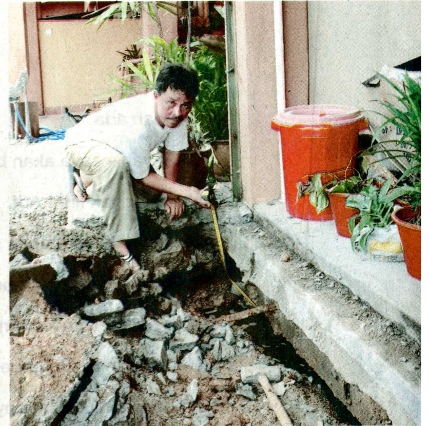
SALAH seorang pemilik rumah di Taman Bangi Perdana, Bangi, Selangor menunjukkan mendapan tanah yang begitu ketara.
