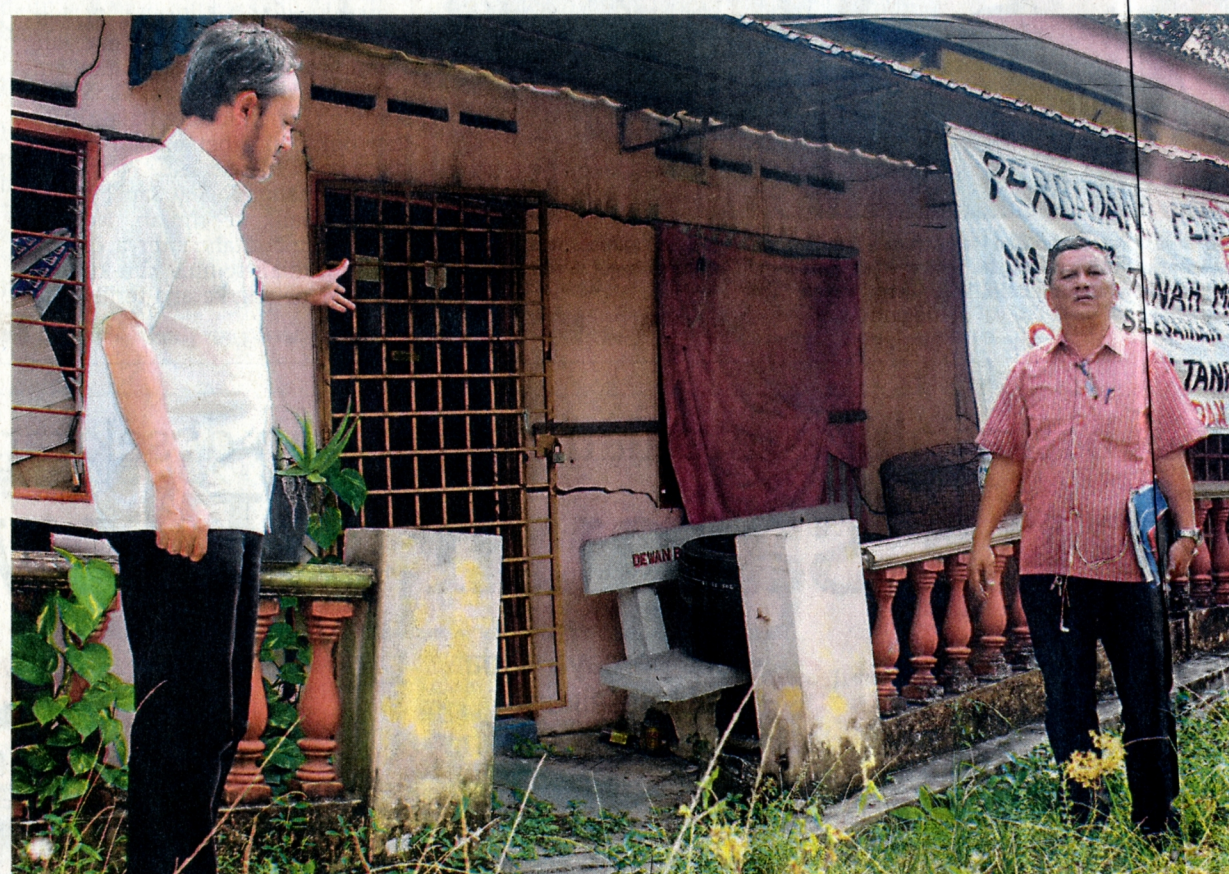
PENDUDUK menunjukkan keadaan sebuah rumah yang retak ekoran tanah mendap di Kampung Pindah di Kampung Baru, Kuala Lumpur baru-baru ini.
