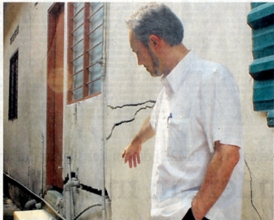
SEORANG penduduk menunjukkan sebuah rumah di Kampung Pindah, Kampung Baru, Kuala Lumpur yang retak-ekoran tanah mendap sejak tiga tahun lalu. - UTUSAN/QAMARIUL RIZAL
