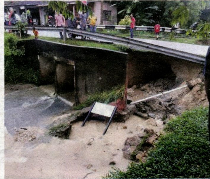
Keadaan hakisan tanah di jambatan berkenaan yang boleh mengundang risiko bahaya buat penduduk setempat.
