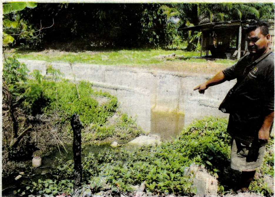
Zulkifli menunjukkan aliran air yang tersekat.
