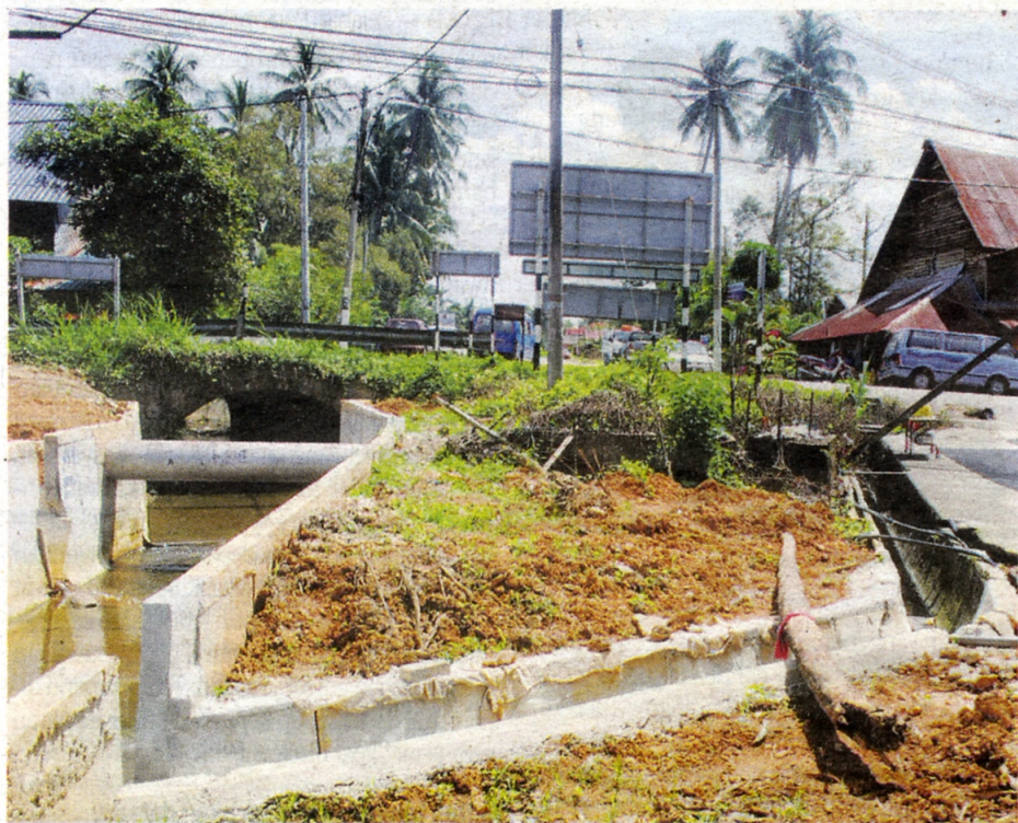
Sistem perparitan yang dibina tidak sempurna sehingga menimbulkan bau busuk.
