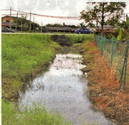
Saliran parit di jalan utama masih tersumbat di Kampung Permatang.
