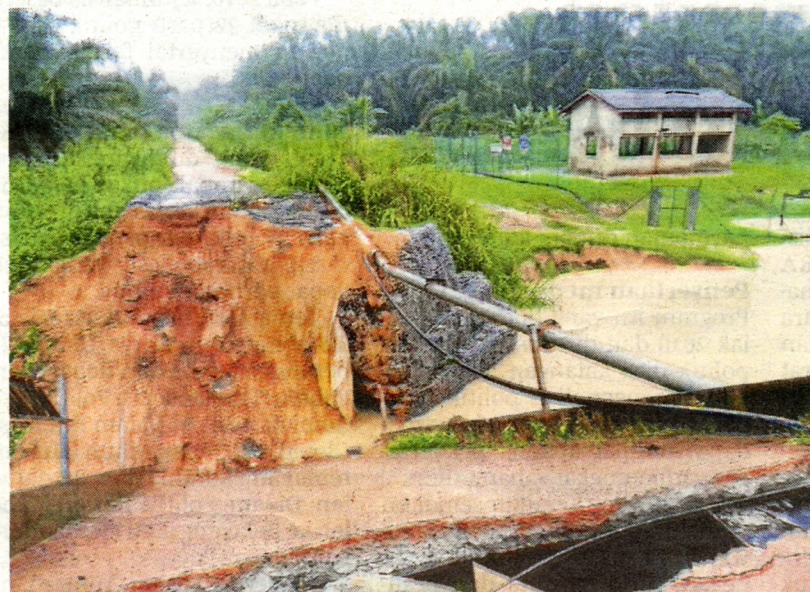
Jambatan di Kampung Sekijang yang runtuh akibat arus deras selepas hujan lebat di Segamat, semalam.
