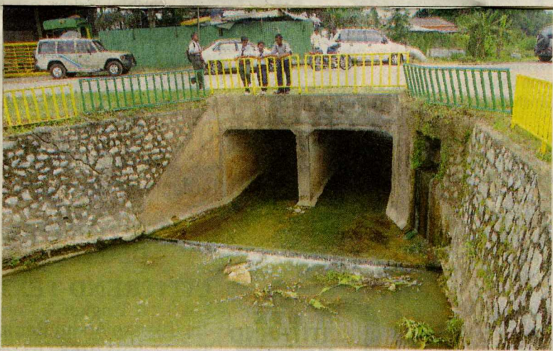
PUNCA TERSEKAT: Laluan di bawah jambatan Sungai Bahau sempit menyebabkan laluan air tersekat mengakibatkan banjir di Bahau.
