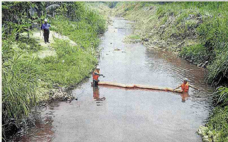
Kakitangan Puncak Niaga memasang Oil Boom untuk menyerap minyak tumpah di sungai sekitar Kuala Selangor. [GAMBAR HIASAN]
