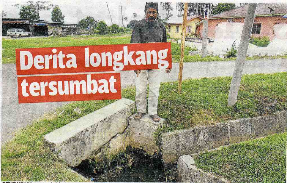
PENDUDUK menunjukkan sistem perparitan yang tidak sempurna.
