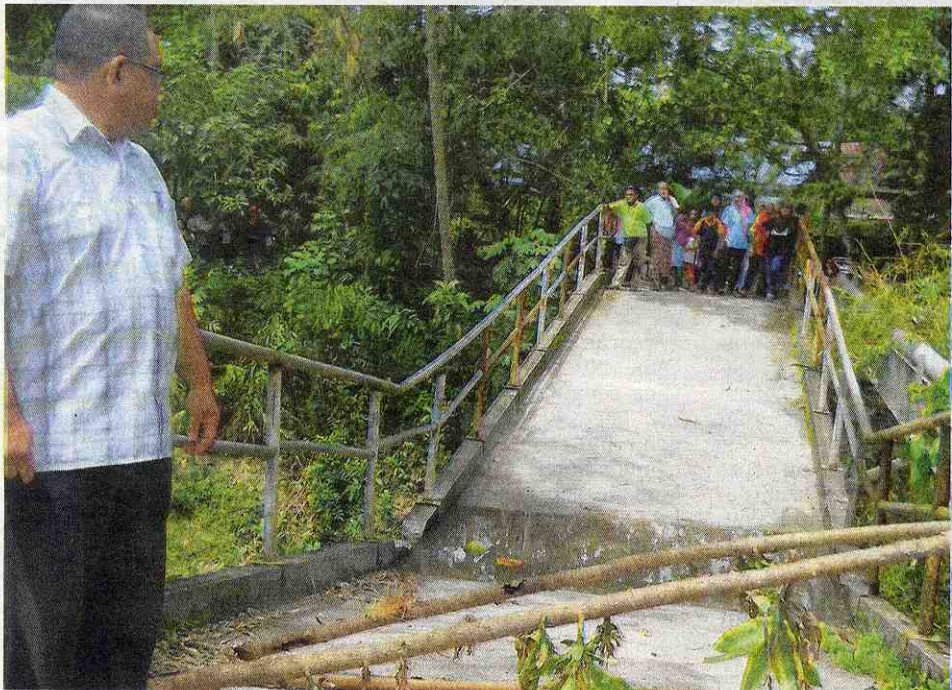
HALIM melihat keadaan jambatan yang runtuh di Kampung Keladi, Kulim, Kedah yang runtuh semalam.
