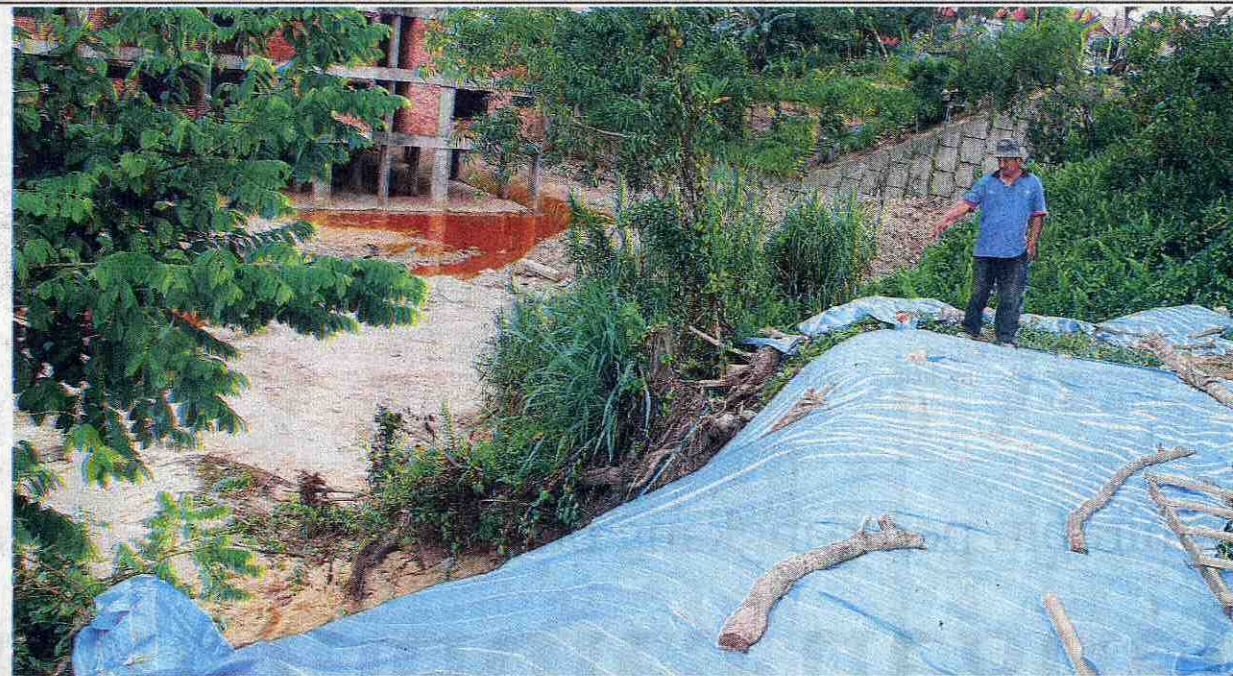
ABDUL Samad Ibrahim menunjukkan tebing takungan air yang runtuh disebabkan air melimpah akibat ketiadaan sistem saliran yang sempurna dari sebuah kawasan projek perumahan ke Kampung Pasir.
