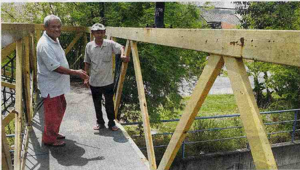
YUSOF (kiri) menunjukkan keadaan besi penghadang jambatan yang rosak dan boleh membahayakan orang ramai di Taman Kosas, Ampang semalam.
