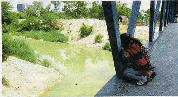
Penduduk bimbang kanak-kanak terjatuh di jambatan tidak berjaring dibina melintasi Sungai Kayu Ara di Lembah Subang.
