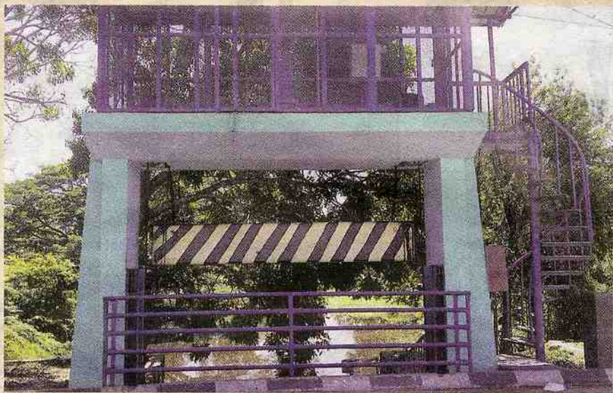
Kunci air di muara Sungai Besar tidak dikelola dengan baik sekali gus menyebabkan halaman rumah penduduk dinaiki air sekiranya hujan.
