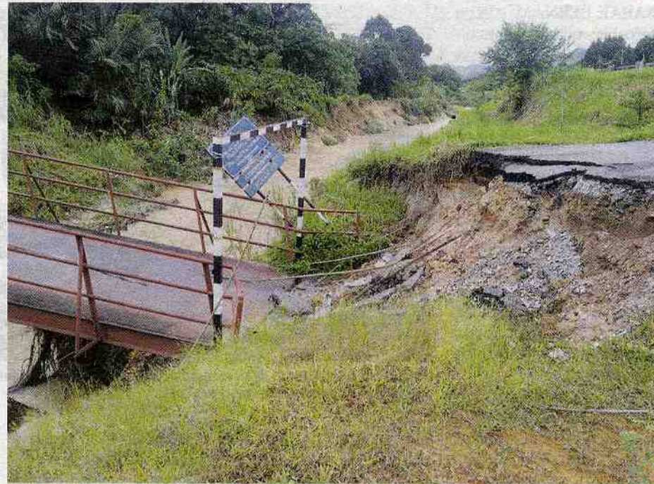
Keadaan jambatan Kampung Lekok yang runtuh akibat hakisan.
