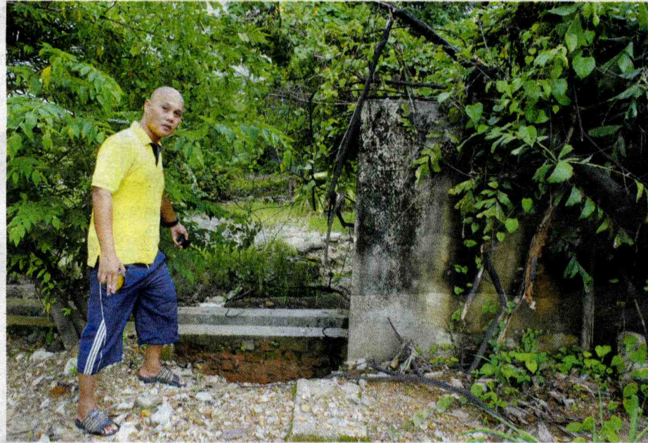
Nordin menunjukkan longkang bermasalah sehingga mengakibatkan banjir lumpur di kawasan rumahnya setiap kali hujan lebat.
