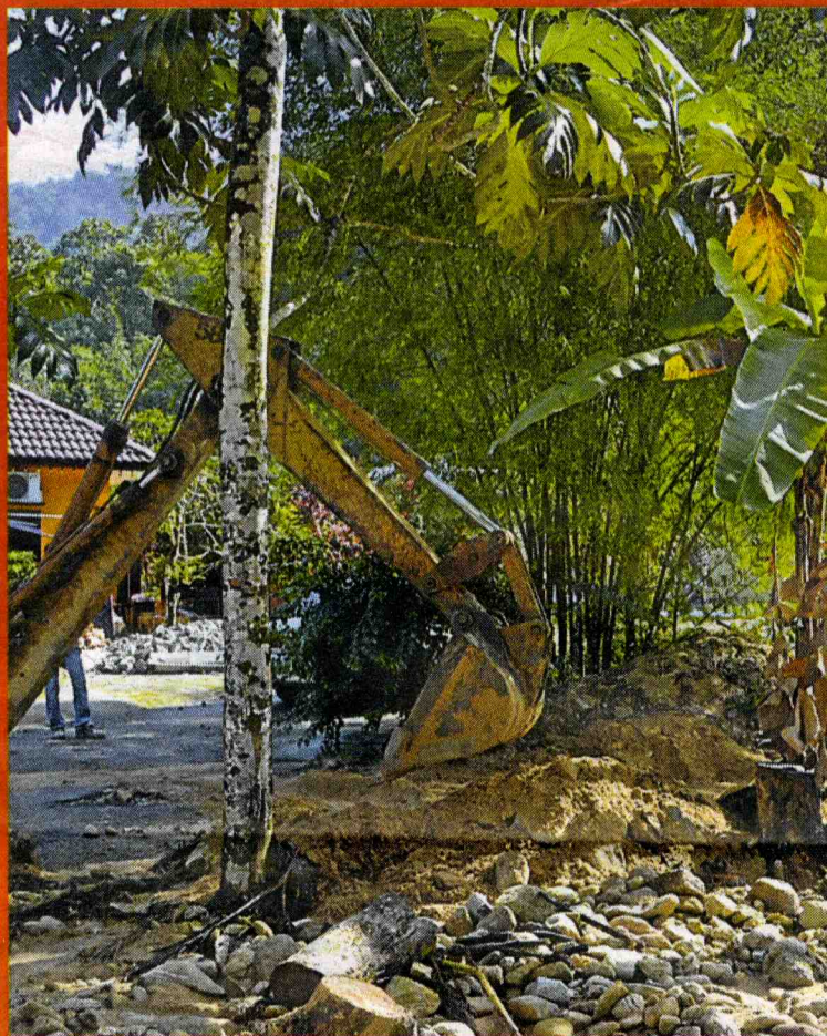
Timbunan tanah menutup jalan masuk ke rumah akibat banjir.
